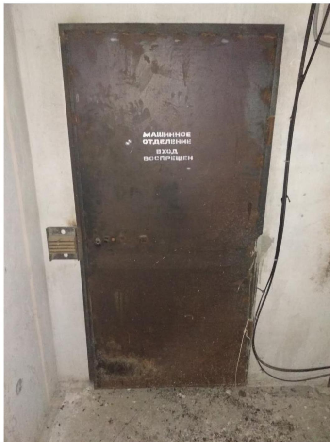
Рисунок 4 – Вход в машинное помещение
