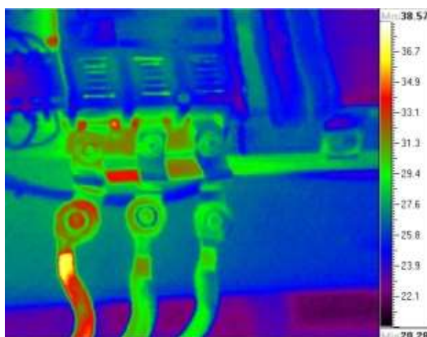
Рисунок 21. Пример термограммы контактных соединений с температурной шкалой
