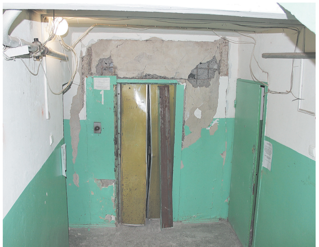
Подъезд на ул. Пионеров, 3 после взрыва баллонов с газом
